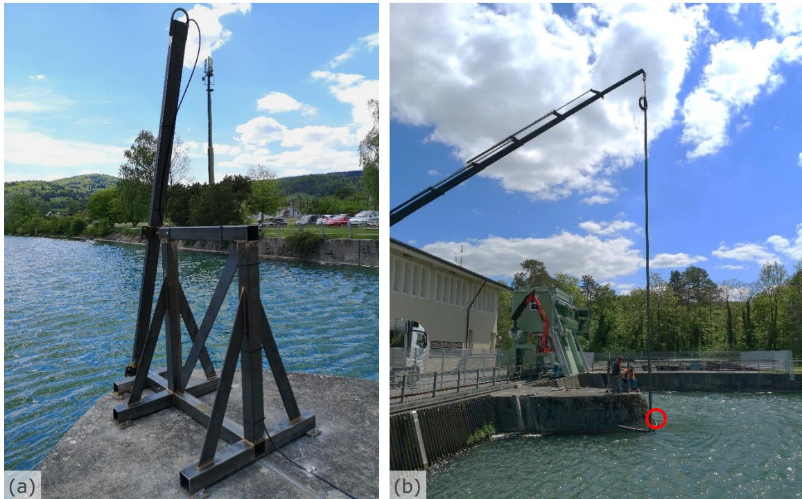
Abb. 4.6 (a) Auf dem Mittelpfeiler montierte Stahlkonstruktion zur Befestigung der in (b) gezeigten langen Stahlhalterung für die Installation eines sohlennahen Hydrophons (rot hervorgehoben).
