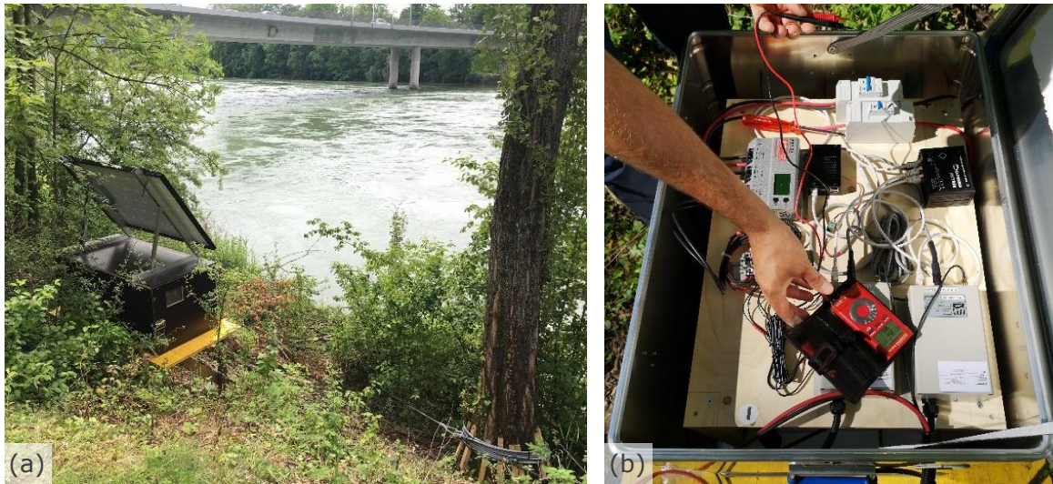
Abb. 4.8 Die Aussenstation in Brugg mit (a) der Plattform (gelbe Holztafel), der Holzbox und dem Photovoltaik-Modul und (b) die Elektronik in der unter der Holzbox positionierten Metallkiste.
