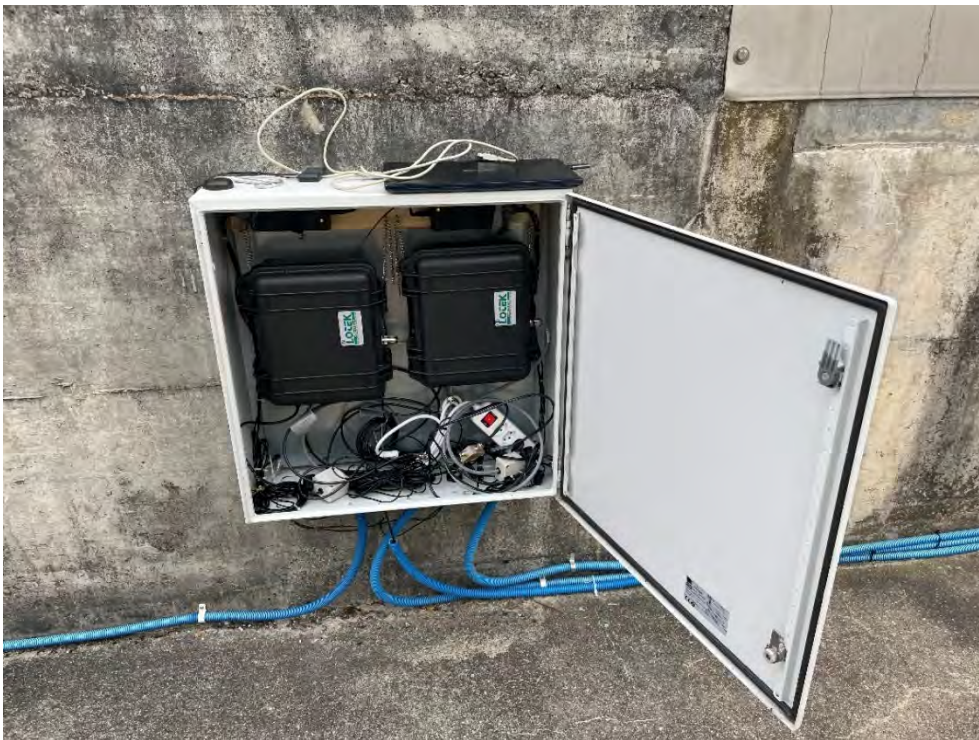
Abbildung 7: Schaltschrank mit zwei Empfängern, welche mit insgesamt vier Antennen im Unterwasser verbunden waren.
