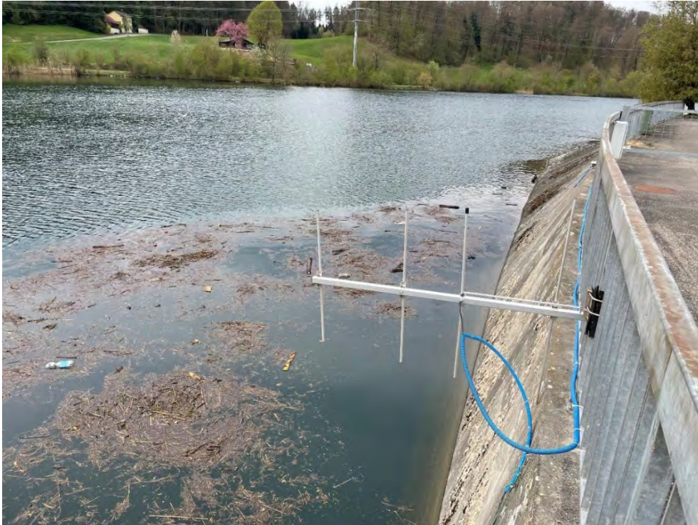
Abbildung 8: 4-Element YAGI-Antenne, welche die Signale der Fische im Oberwasser vor den Turbinen empfängt. Der Empfänger wurde in einem Schaltschrank (am Geländer befestigt) wasserfest und mit Strom versorgt untergebracht.
