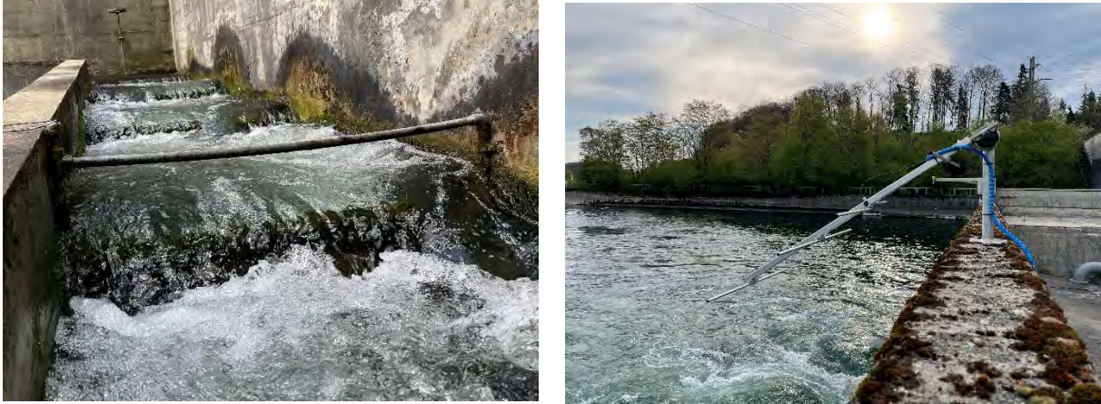
Abbildung 14: Links: PIT-Tag-Antenne im Fischpass; Rechts: YAGI-Antenne YD2 über den Turbinenausgängen
