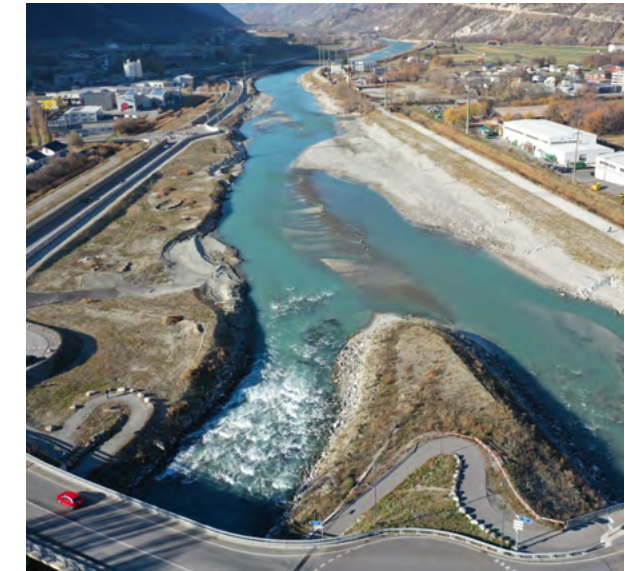
Bild: Einmündung der Vispa in die aufgeweitete Rhone, ©DNAGE Titelbild: Rhone bei Baltschieder im Abschnitt des fertiggestellten Loses 5, ©DNAGE
