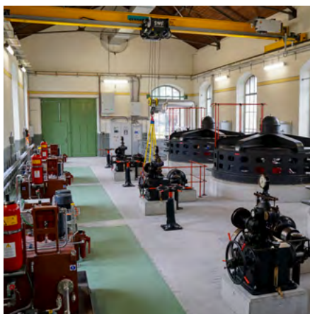
Die Maschinenhalle nach dem Umbau: die alten Abdeckhauben und Hilfsaggregate sind wieder an ihrem Platz.
