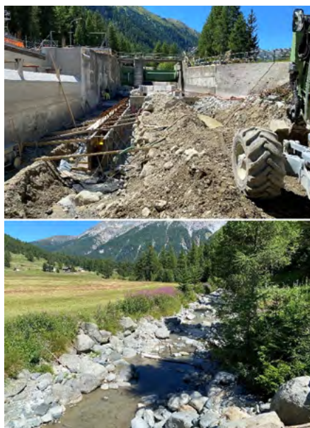
Wasserfassung und Vallember unterhalb Fassung; Bild: SWV.
