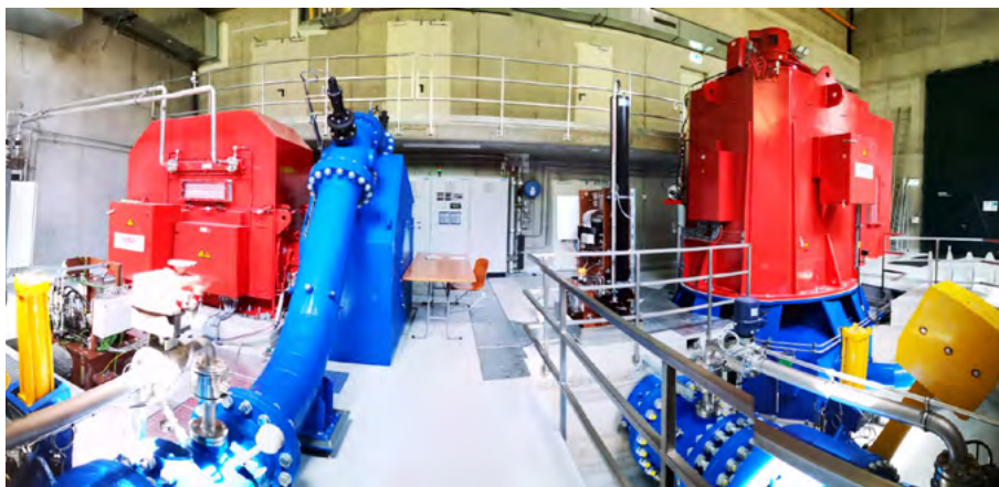
Die zwei Wasserturbinen und Generatoren in der Kraftwerkszentrale Schils der SAK in Flums (Bild: SAK).
