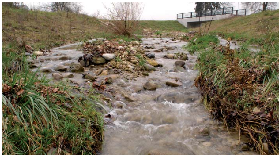
Bild 1. Sagentobelbach in der Flachstrecke (1.5%–2.0%). Aufnahme vom November 2012 (nach dem grossen Hochwasser vom 3. Juli 2012) (Quelle: Basler&Hofmann AG).
