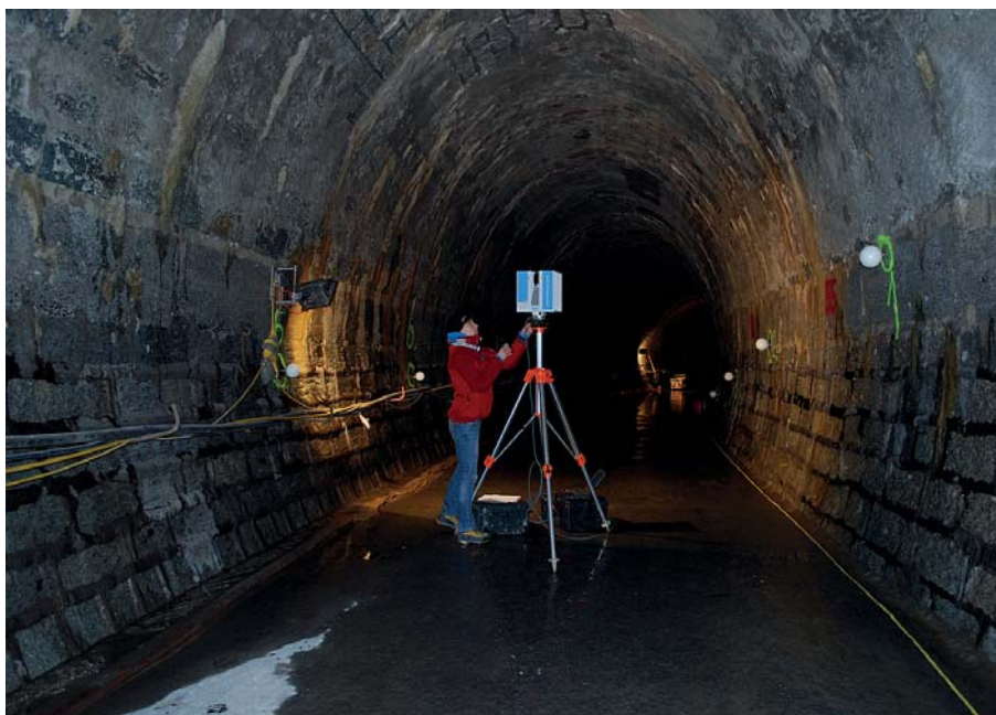
Bild 5. Vermessung der Stollensohle mittels 3D-Laserscanner im Sediment-Bypass Pfaffensprung; die an der Stollenwand montierten Zielmarken (weisse Kugeln) dienen als Referenz und ermöglichen eine millimetergenaue Bestimmung der jährlichen Abrasionen (Foto: VAW).
