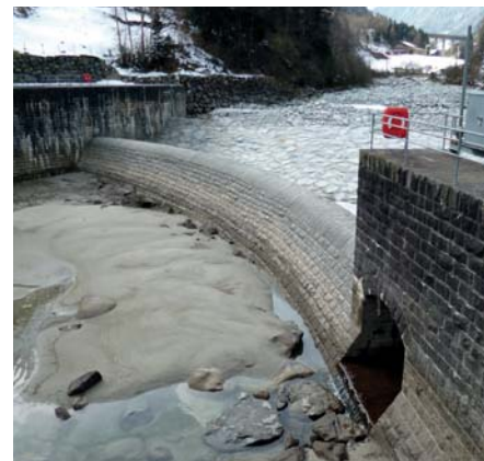
Bild 1. Das Leitwehr beim Ausgleichsbecken Pfaffensprung bei Wassen (UR) staut die Reuss, sodass Geschiebe durch den Stollen umgelenkt werden kann.
