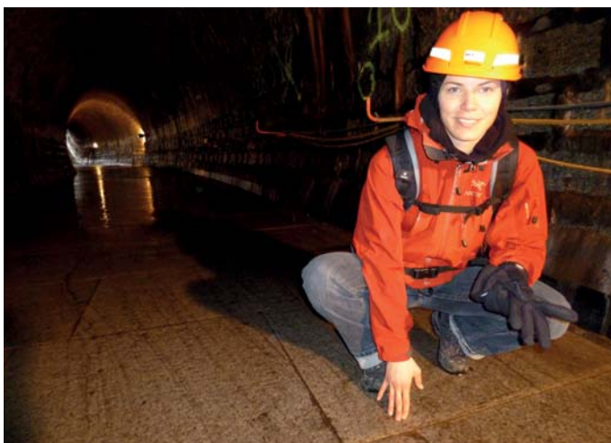
Bild 2. ETH-Forscherin Michelle Hagmann begutachtet die Granitplatten am Boden des Umleitstollens Pfaffensprung im Kanton Uri. Im ersten Jahr der Untersuchung wurden die Platten durch Geschiebe durchschnittlich um 0.3 mm abgetragen.
