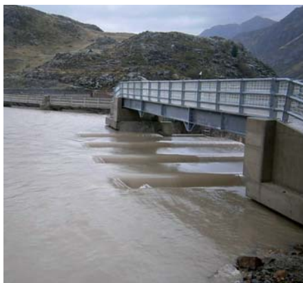
Klaviertasten-Wehr der Gloriettes Bogenmauer in Betrieb (Foto EDF).
